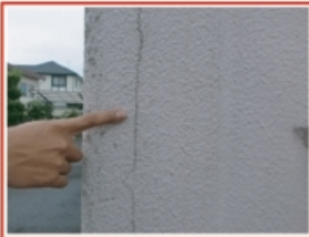
壁のヒビ割れ
