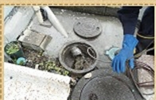
トイレ、 排水のつまり
